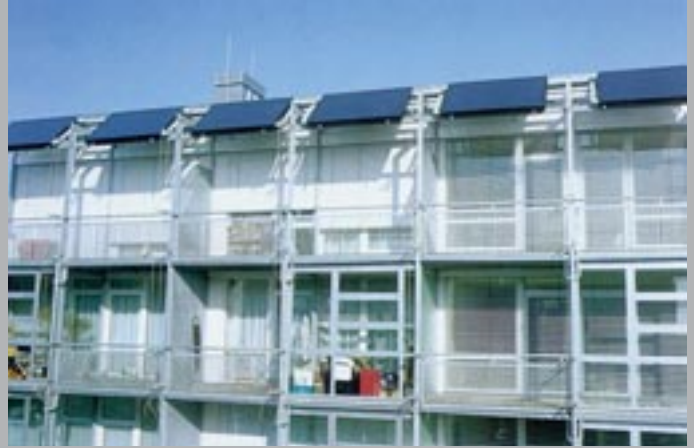
Ejemplo de instalación solar con doble función: - A.C.S. para la vivienda - Sombra en verano para reducir el consumo de aire acondicionado
